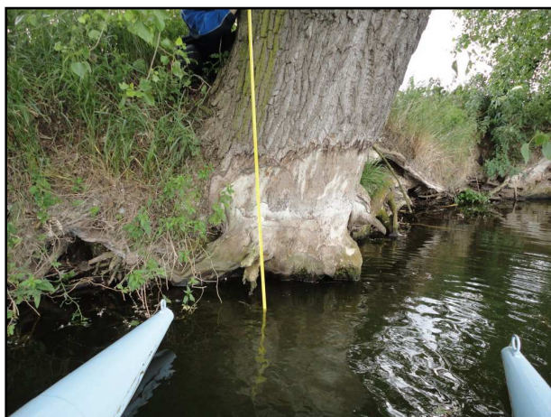
Obrázek č. 46, 47: Stávající stav vnitřního břehu slepého ramene
